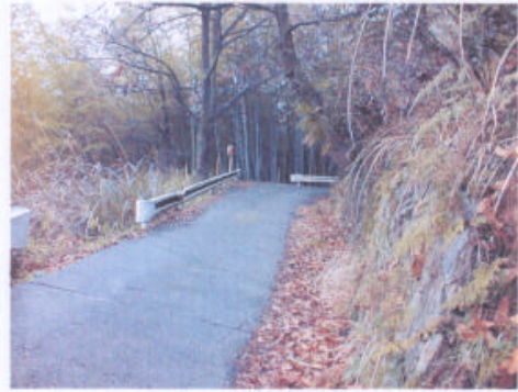
⑦白原車庫上道の曲がり、健全なり。
